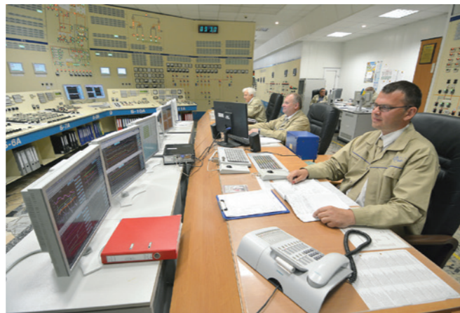
Блочний щит керування блоку № 2
