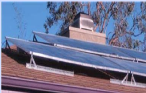
Рис. 3 - Помилки монтажу та значне вигинання каркасу ФЕМ
