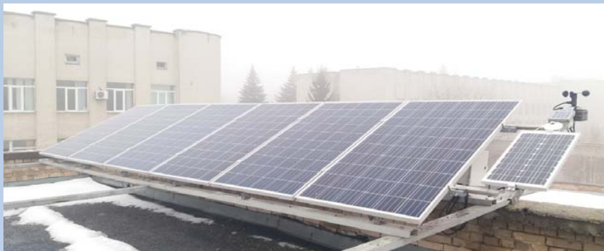
Рисунок 1– Фотоелектрична станція 1.6кВт на будівлі ФЕЕЕМ ВНТУ
